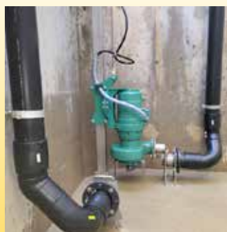
Position zur Beförderung in die Gülle-Lagerung oder zum Fassfüllen
